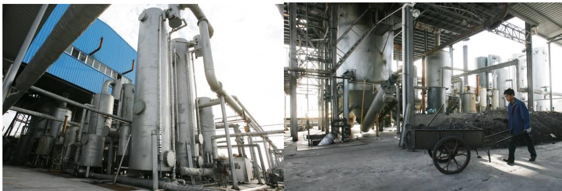
两步法水煤气站—外景 两步法水煤气站—工人操作中
