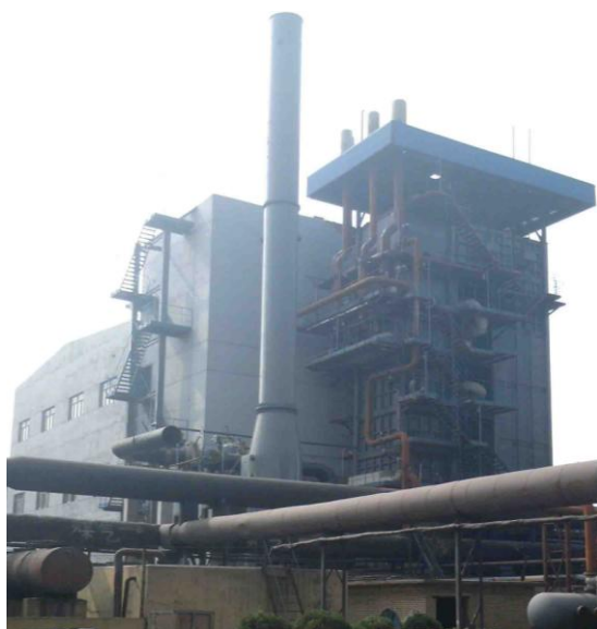
10MW 余热发电主厂房
