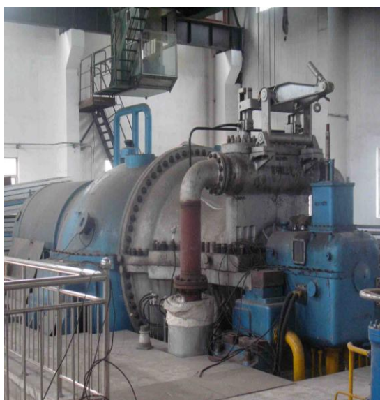
10MW 余热发电机组
