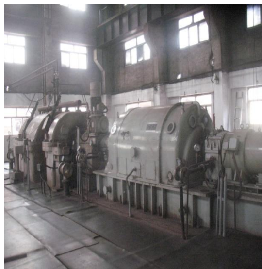
4.5MW TRT 发电机组
